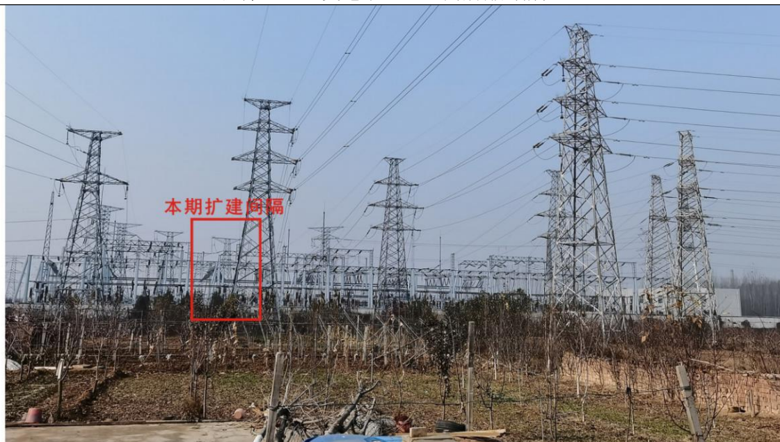
澧都220kV变电站110kV间隔扩建侧照片
