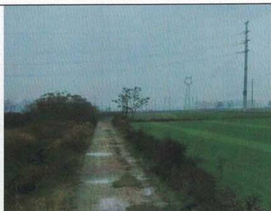
变电站东侧 110kV 配电区
