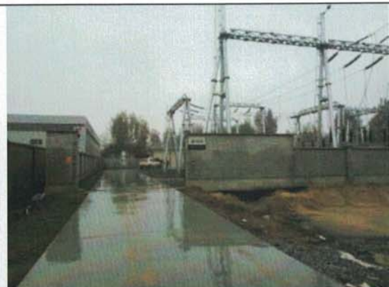
变电站现状照片
