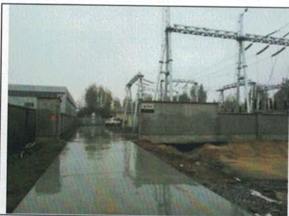
变电站现状照片
