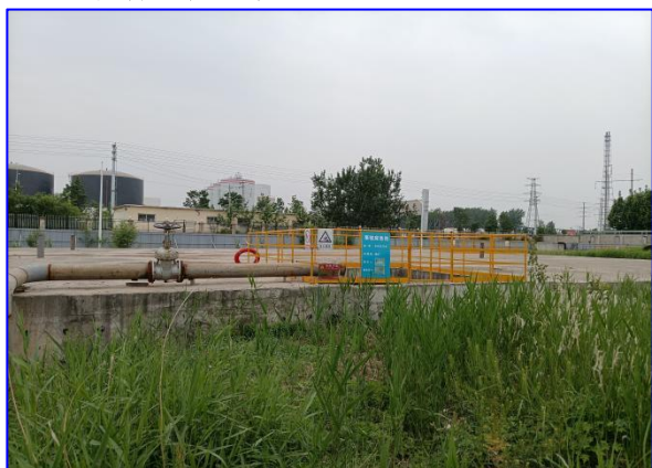
现有工程事故水池
