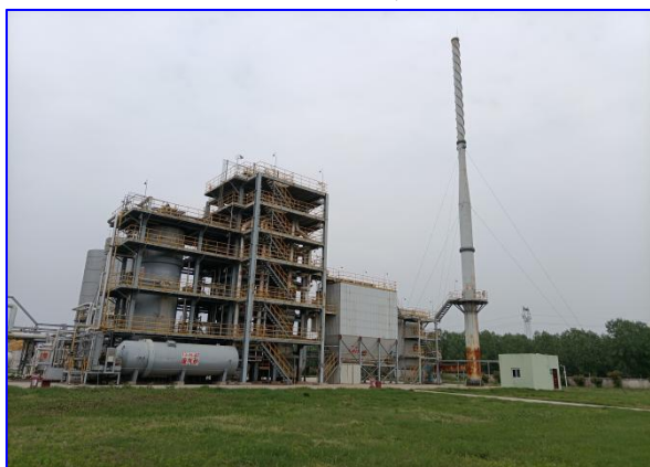
现有工程焚烧炉
