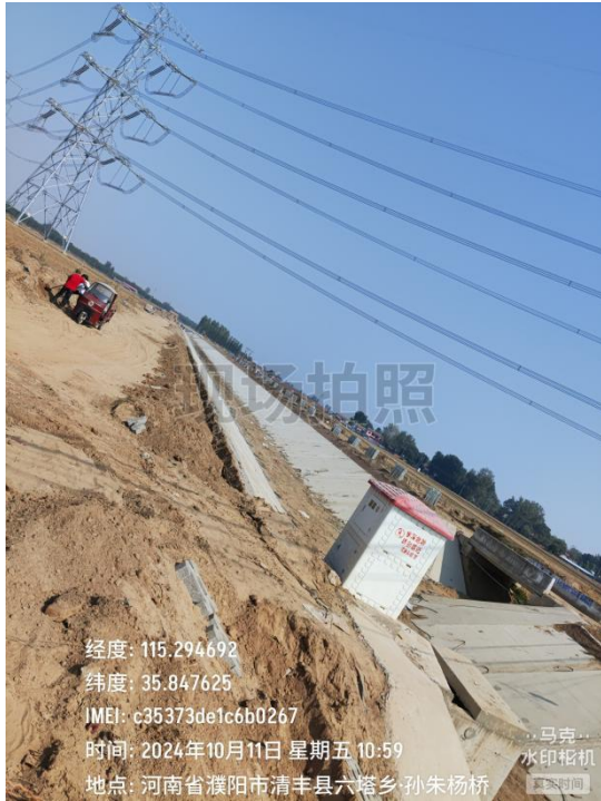
线路跨越第二濮清南北干渠
