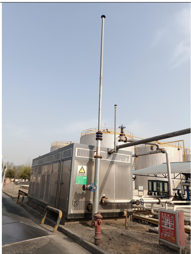
油气回收装置及其配套的排气筒（DA003）
