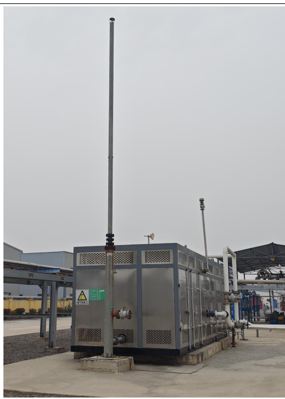
油气回收装置及其配套的排气筒（DA005）
