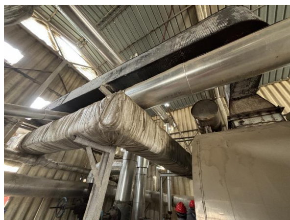
导热油炉烟气循环系统
