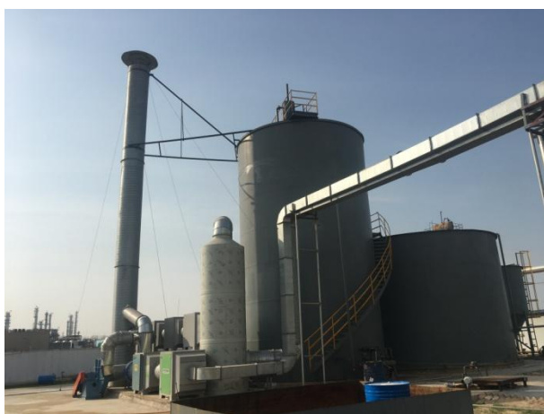
废气治理设施
