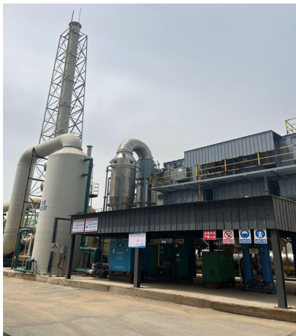
RTO 尾气处理装置
