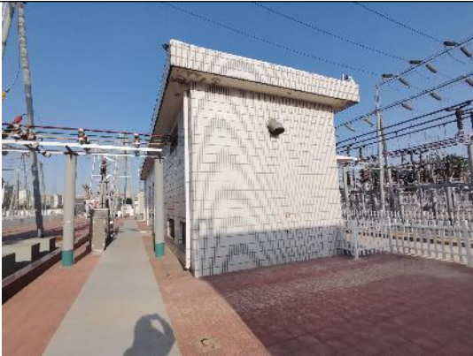
10kV 配电装置室
