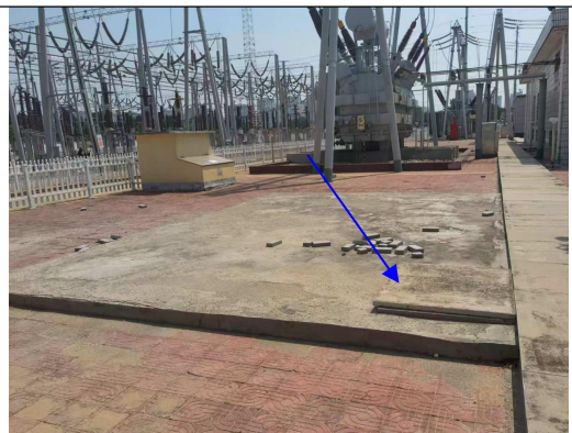
站内事故油池
