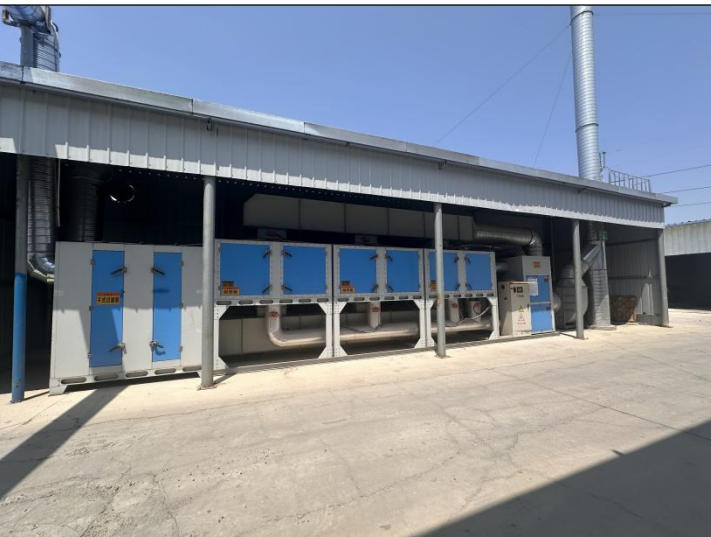
项目 1 套干式过滤器+活性炭吸附+催化燃烧处理装置
