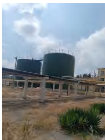
联合站消防水罐
