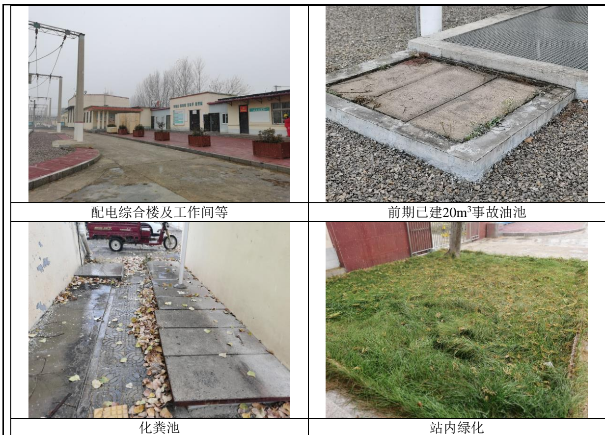
图1-3 变电站已建电气设备及相关环保设施
