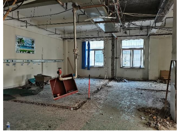
DSA 机房内部
