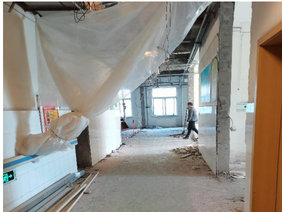
DSA 机房患者通道
