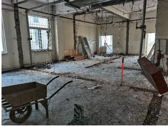
DSA 机房内部
