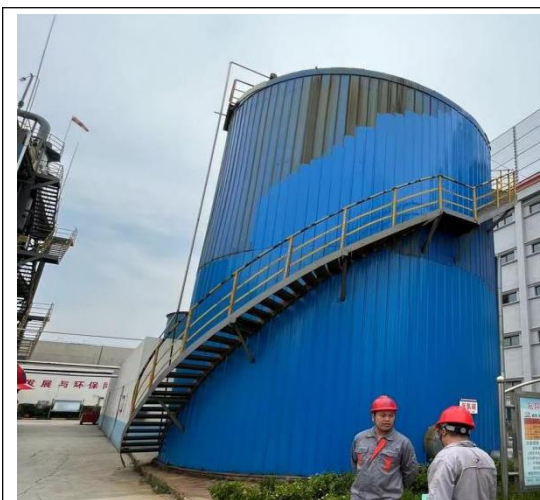
现有污水处理站
