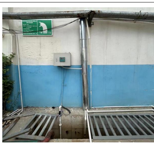
现有厂区废水总排口
