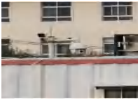
雨水排污口监控设施
