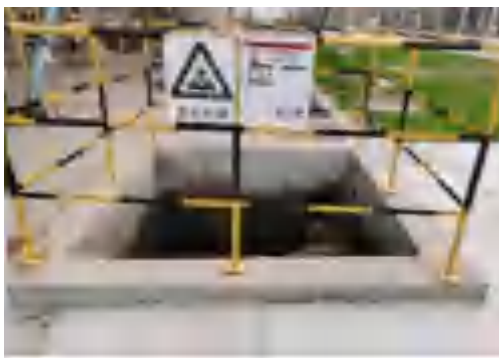
生产装置雨水收集池
