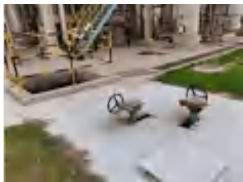
生产装置雨污切换阀
