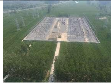
舜泽 220kV 变电站
