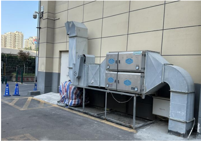
现有工程油烟净化器+排气筒
