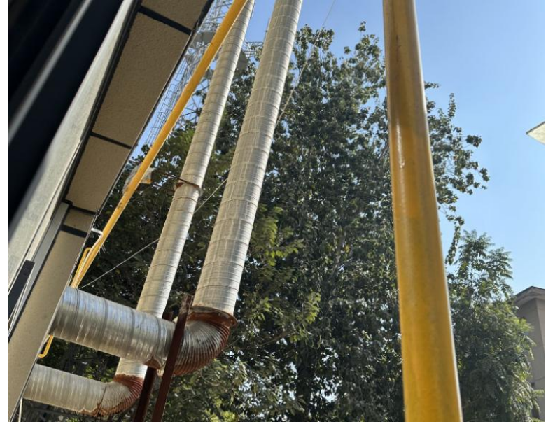
现有工程燃气废气排气筒
