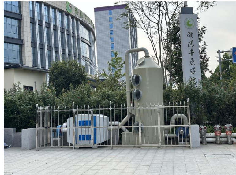
现有工程污水处理站恶臭处理装置
