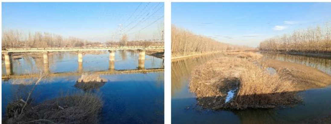
图3 濮阳县金堤河河道淤积现状
